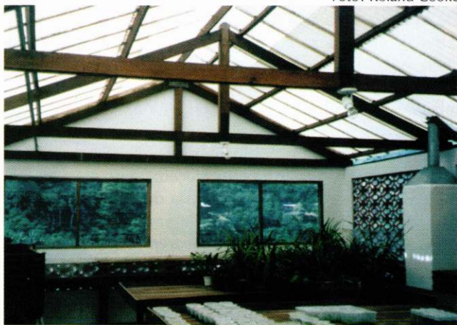
Estufa de alvenaria (Orchidcastle - Petrópolis), com telhas translúcidas (leitosas), medindo 8 x 6m. Note as grandes janelas com tela e a parede dos fundos em cerâmica vazada, garantindo ótima ventilação.
